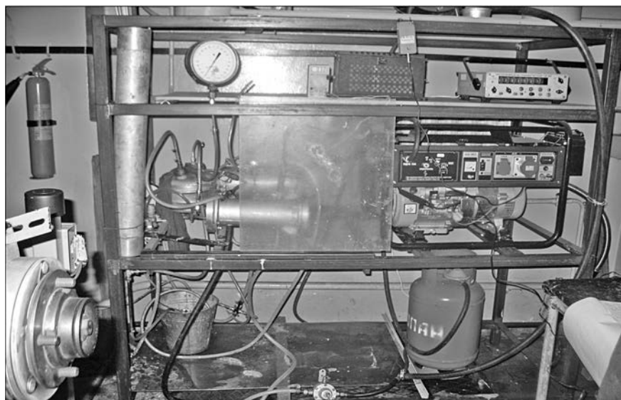
Рис. 9.10. Фото установки водородного газогенератора
